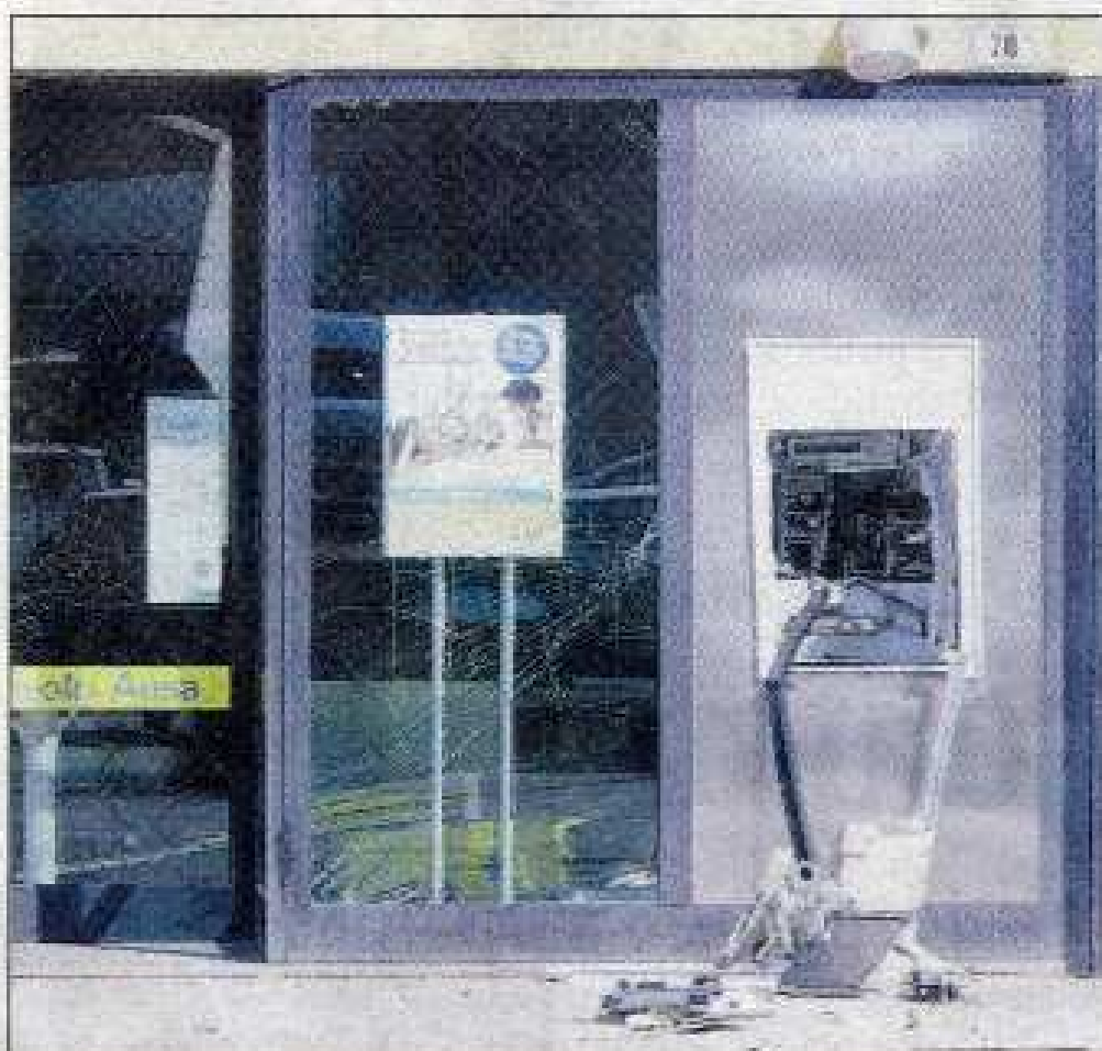
La carica esplosiva ha distrutto buona parte della vetrata
