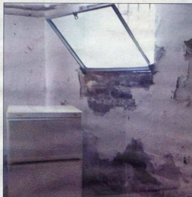
Una parete interna dell'edificio devastata dall'umidità
