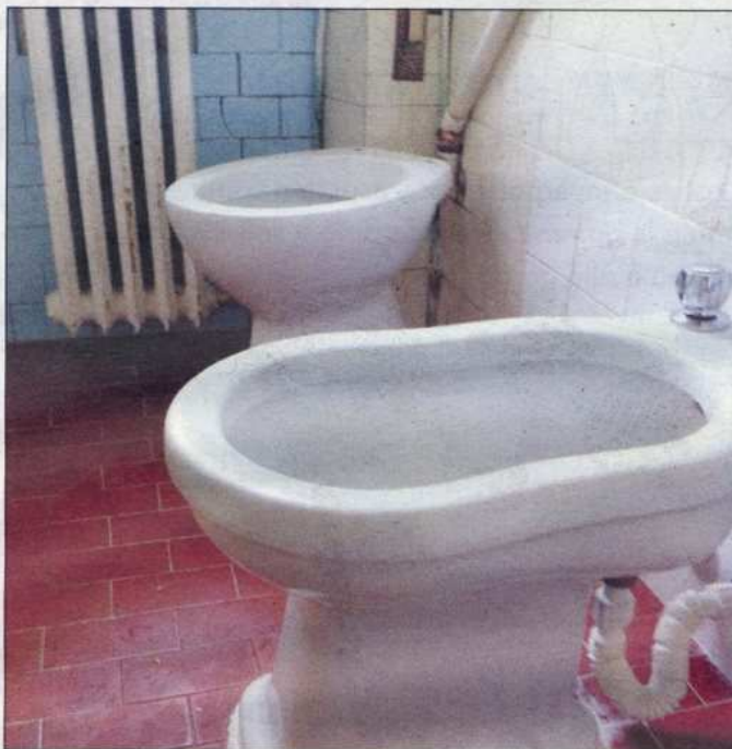
Sanitari vecchi e rotti in un bagno della struttura
